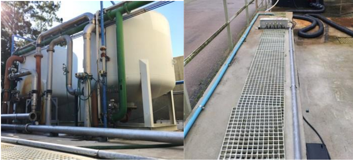
Figura 19. Sistema de tratamento terciário com filtros de areia e desinfecção UV.
