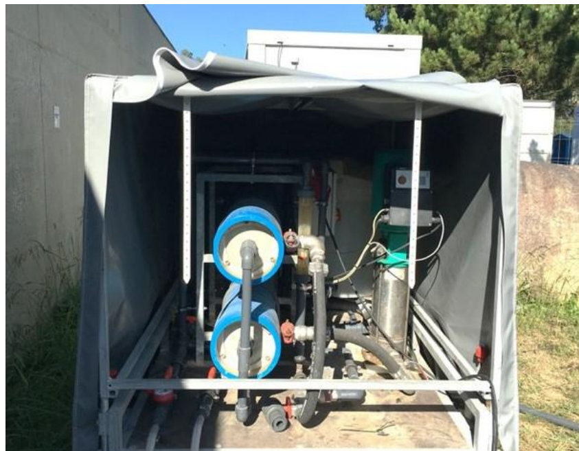
Figura 21. Unidade piloto de nanofiltração.
