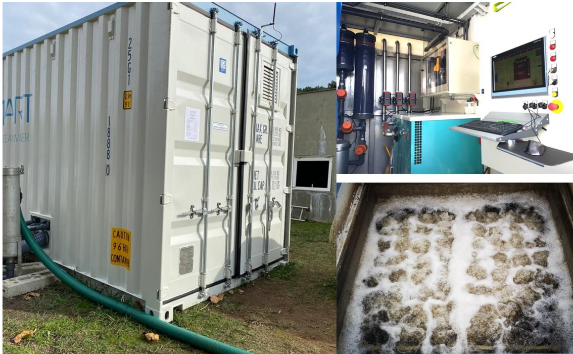
Figura 20. Unidade contendorizada de ultrafiltração.
