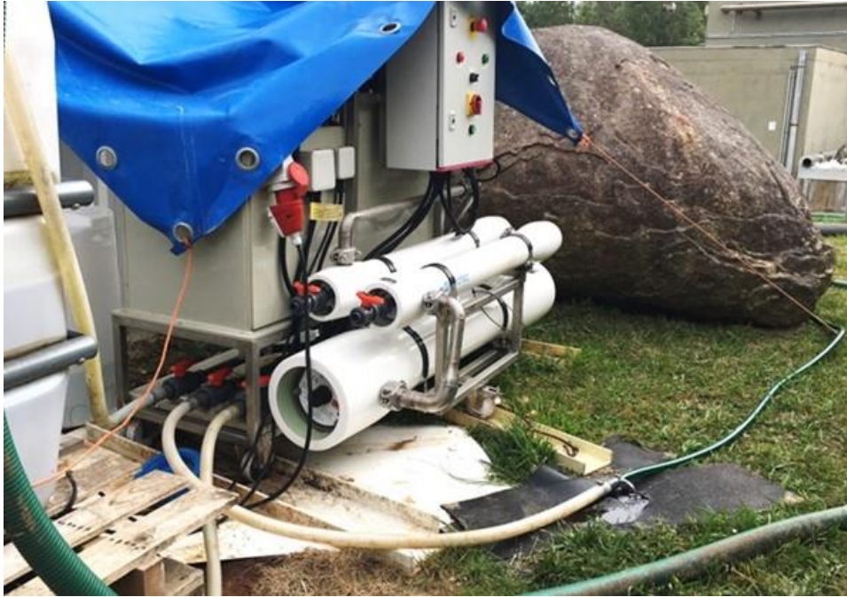
Figura 22. Unidade piloto de osmose inversa.
